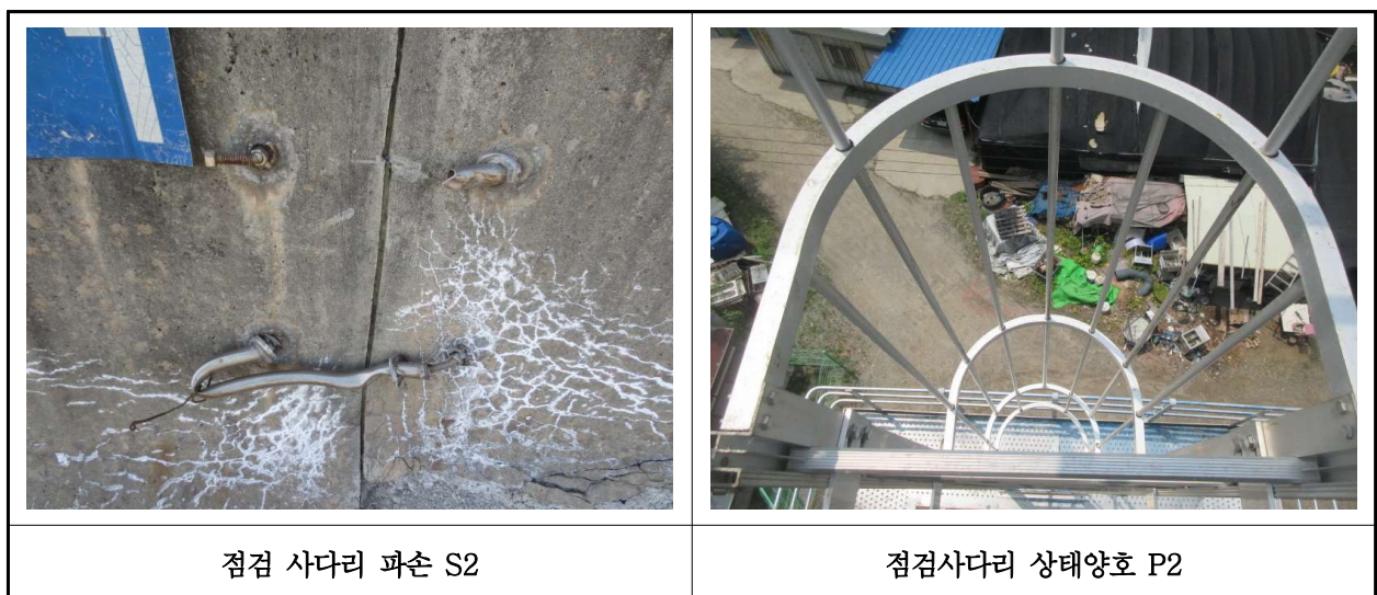
【사진 1.3.24】 교량 점검시설 손상현황
