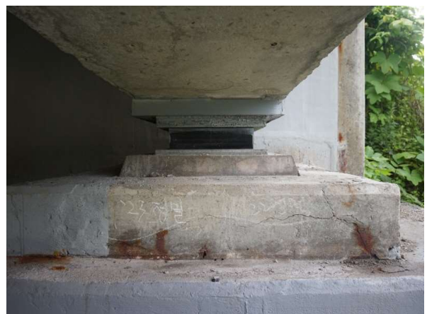
받침콘크리트 박리/철근부식 A1 SH1
