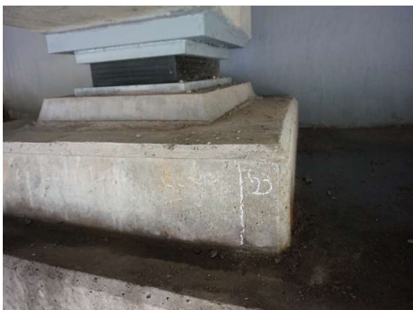
받침콘크리트 균열(0.3mm미만) A1 SH3
