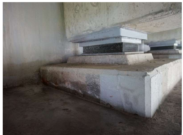
받침 콘크리트 박리/철근부식 A1 SH5
