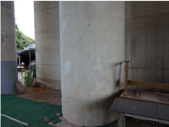
교각 망상균열 P1
