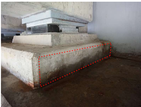
받침콘크리트 박리/철근부식 A1 SH6
