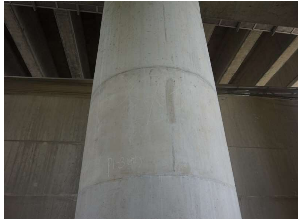
교각 망상균열 P1
